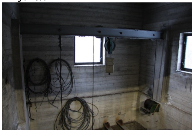
Over sjaktåpningen i vest er kran for heising og senkning av lodd.
