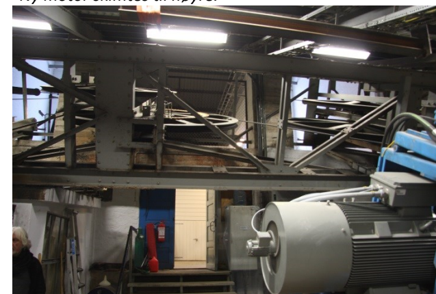
Drivverk med stativ over åpningen mot vognrommet. Ny motor skimtes til høyre.
