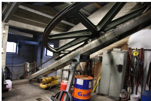
Drivverk og sjakt i vest.
