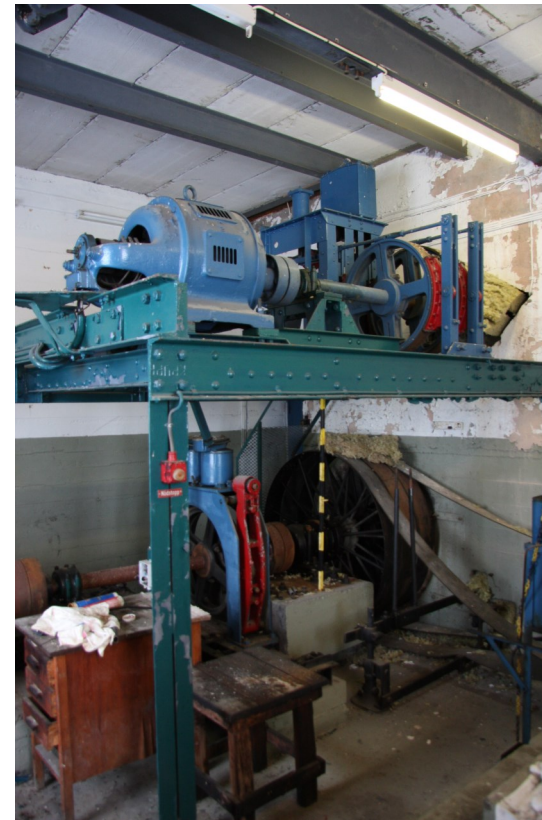
Maskinrommet med en 50 hestekrefters elektrisk vekselmotor fra Siemens under og 22 hestekrefters reservemotor med eget reservedriftsmaskineri på stativ over . Opprinnelig ble banen driftet herfra med dette maskineriet, men ble avløst av en moderne motor på nedre stasjon i 1990-91.
